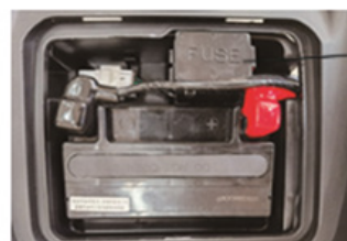
Caja de fusibles
